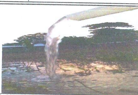
Foto 2: POZO. EL AGUA DEL POZO YA SE VE EN UN 75% DE CLARIDAD.
