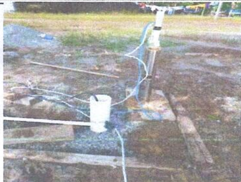
Foto 1: POZO. INTRODUCCION DE LA BOMBA PARA DISTRIBUIR AGUA HASTA EN LAS INSTALACIONES DEL EDIFICIO ESCOLAR.
