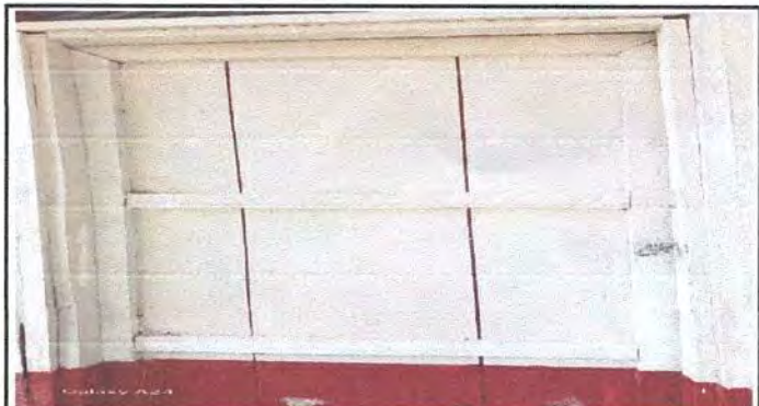
Foto 4: MODULO DE COCINA Sustitución de puerta
