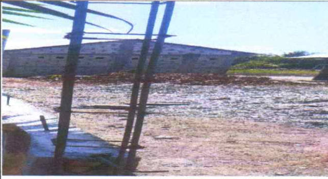
Foto1: La base del porton principal del muro perimetral de la escuela.
