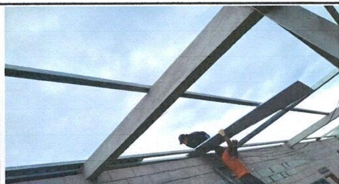
Foto 3: Estructura de madera a cambiar por metal.
