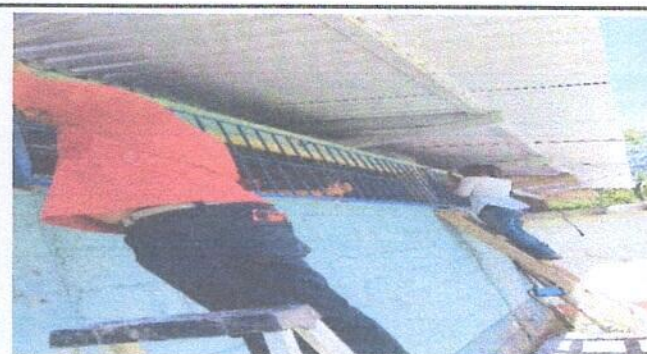
Foto 5: Sustrucción de balcones de metal parte de atrás
