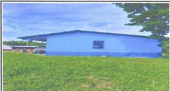
Foto 3: Techo dañado por laminas troqueladas.
