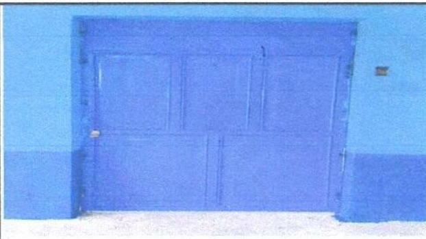
Foto 4: Puertas a cambiar.
