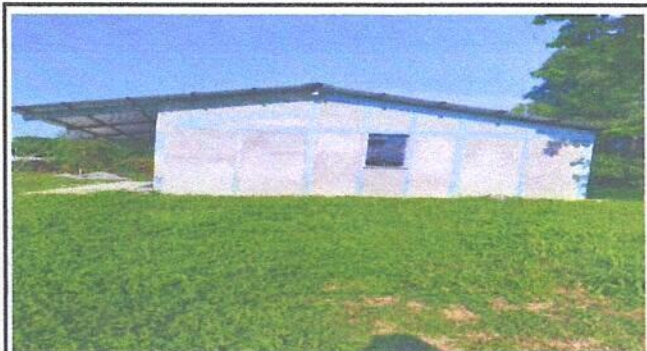
Foto 3: Techo dañado por laminas troqueladas.
