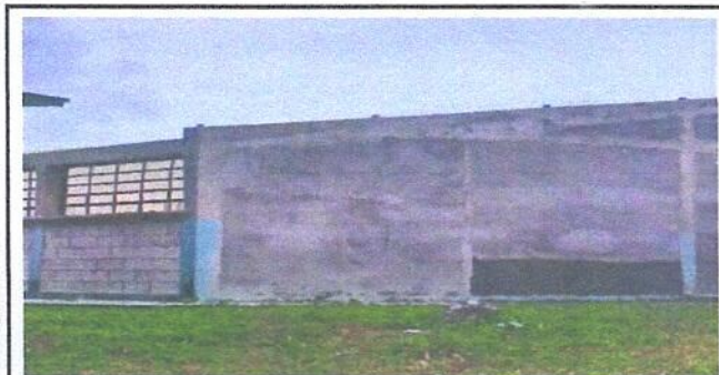
Foto 5: Parte dañada que cubrira la pintura.
