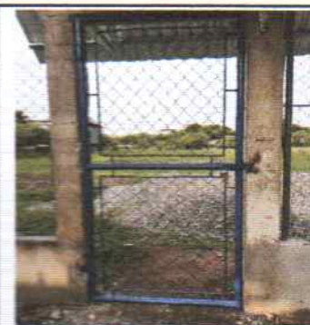
Foto 5: ASI QUEDÓ LA PUERTA DE EMERGENCIA.
