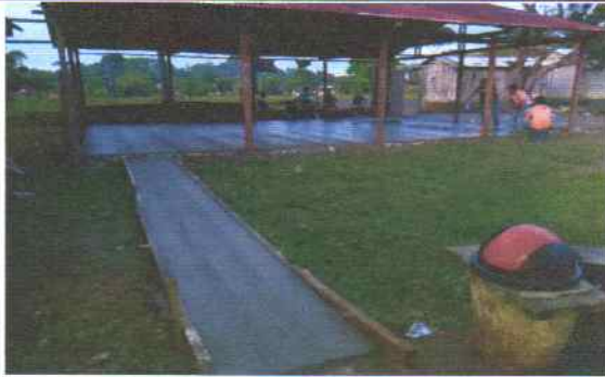
Foto1: EL PISO DEL AULA TORTA DE CONCRETO.
