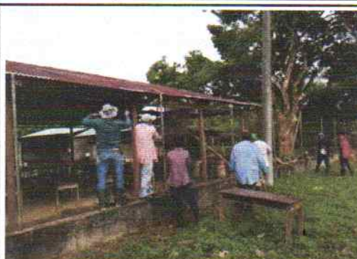
Foto 2: MODULO 1. DESMONTAJE DE MALLA DETERIORADA POR PADRES DE FAMILIA.
