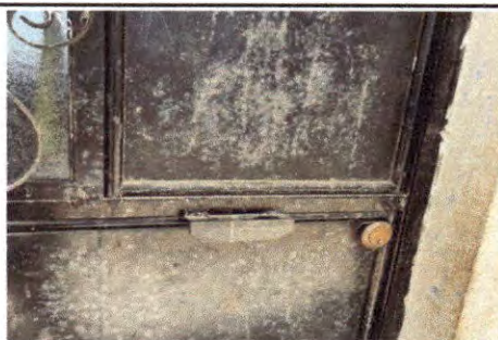
Foto 5: PUERTAS DE METAL DE AULAS, CON PINTURA EN MAL ESTADO.
