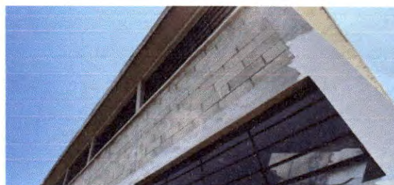
Foto 4: PARTE POSTERIOR DEL SEGUNDO NIVEL, TAMPOCO CUENTA CON PINTURA.
