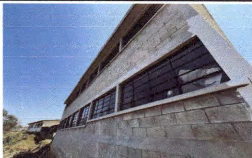
Foto1: FALTA DE BALCONES DE SEGURIDAD EN PARTE POSTERIOR DEL MODULO.
