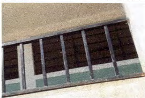
Foto 7: BARANDAS DE METAL DEL SEGUNDO NIVEL CON PINTURA DAÑADA.
