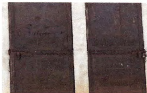
Foto 6: PUERTAS DE METAL DE LOS SANITARIOS, DETERIORADAS.
