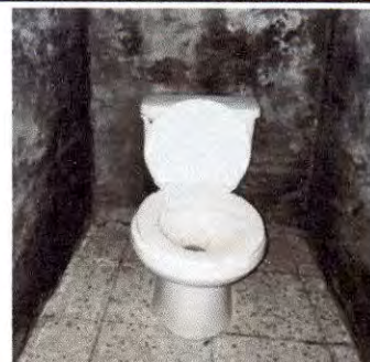
Foto 8: SANITARIOS EN BUEN ESTADO, PERO SIN USO POR FALTA DE CONEXION DE AGUA POTABLE.
