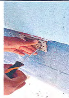
Módulo 1: Sustitución de toma corriente doble
