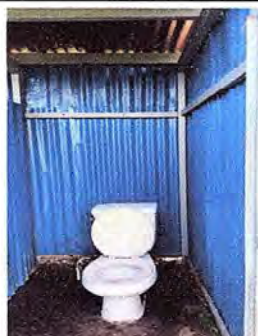
Foto1: El sanitario 1 se encuentra en malas condiciones y ya no funciona
