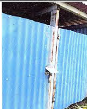
Foto 3: La estructura (pared) de los sanitarios se encuentran deterioradas
