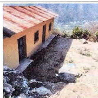
Foto 6: Se necesita terminar la pavimentación del corredor para evitar accidentes hacia los niños
