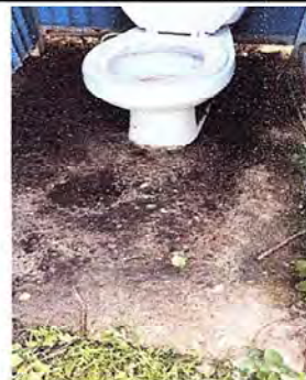
Foto 2: El sanitario 2 también se encuentra en malas condiciones y el pavimento se lleno de tierra por las lluvias
