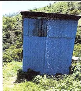
Foto 4: : La estructura (pared) de los sanitarios se encuentran deterioradas
