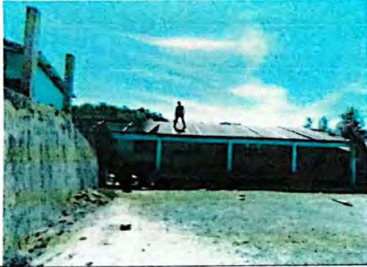
Foto 1: Situación techo remosando edificio dos parte baja.
