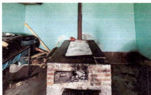
Foto 4: PLANCHA DE ESTUFA EN MALAS CONDICIONES.
