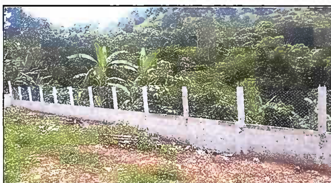
Módulo 2: El muro al lado norte del predio de la escuela.
