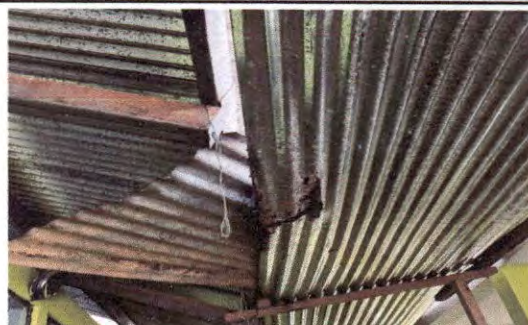
Foto 2: ESTRUCTURA PORTANTE DE MADERA DEL TECHO DETERIORADA.
