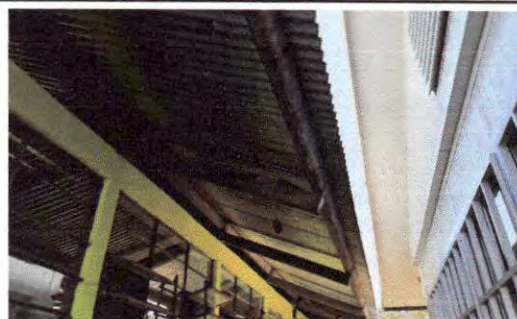
Foto 4: EL TECHO DE LAMINA NO CUENTA CON CANAL PARA BAJADA DE AGUA SOBRE EL PASILLO DE ACCESO PRINCIPAL
