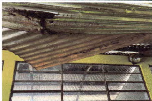
Foto 1: TECHO DE LAMINA SOBRE EL CORREDOR DE AULAS, YA DESPRENDIDA Y CAIDA.
