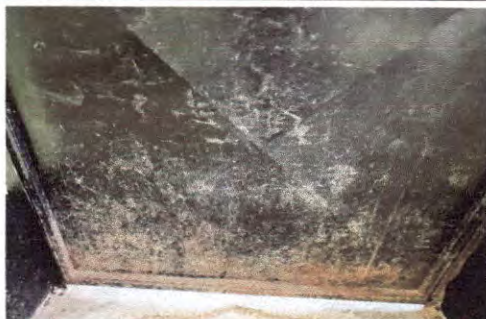
Foto 3: PUERTAS DE METAL DE AULAS, EN MAL ESTADO Y OXIDADAS.
