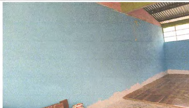
Foto 14: Repello en paredes
