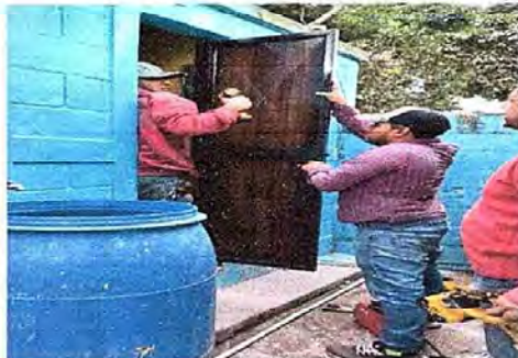
FOTO 7: MODULO 2: Sustrucción de puerta en servicios sanitarios.
