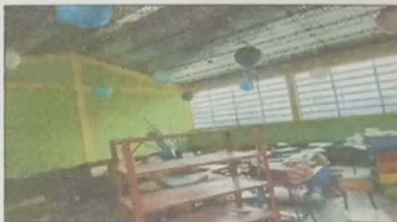
Foto 4: Pintura interior de la escuela
