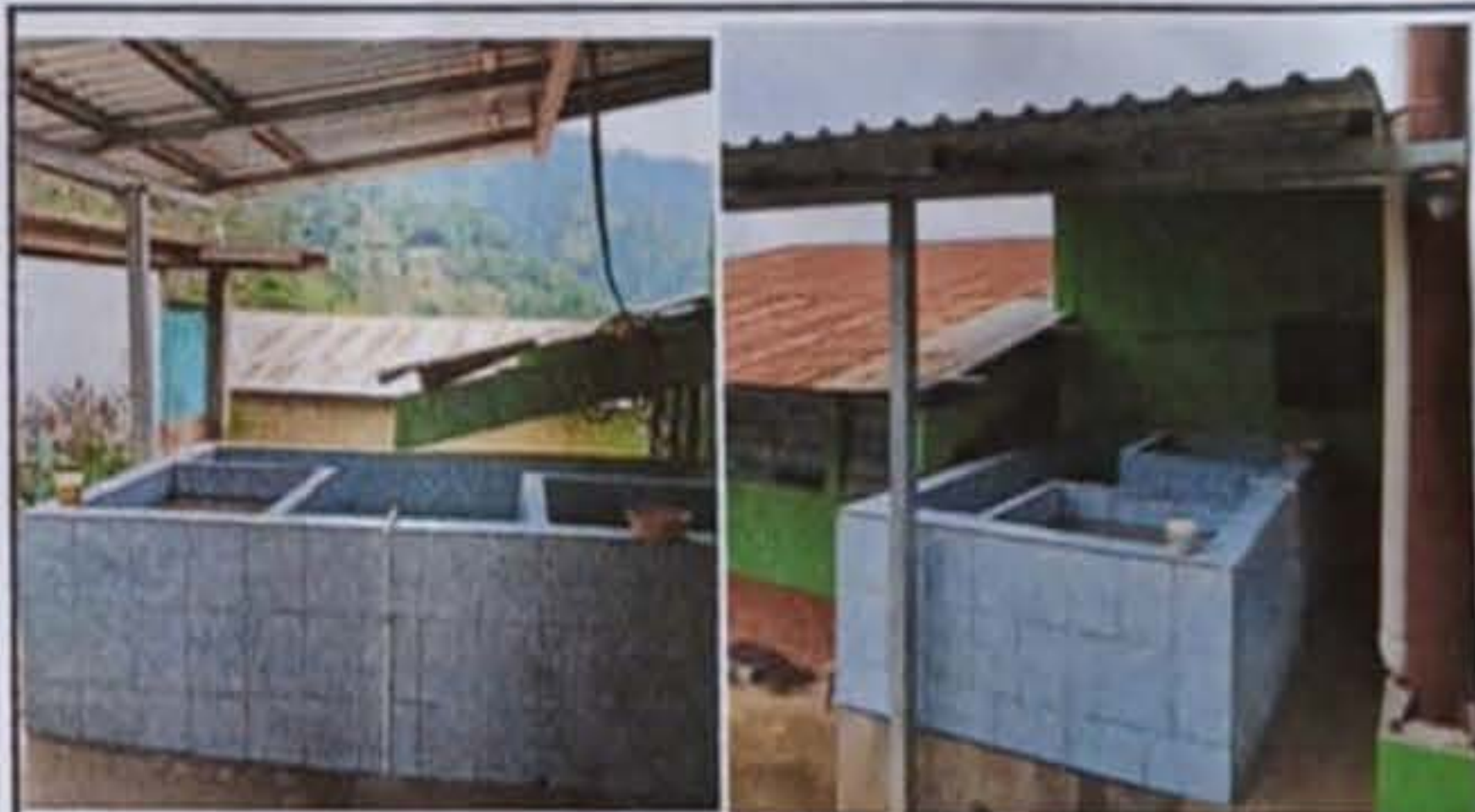
Foto 4: remorzamiento para pila de un lavadero
