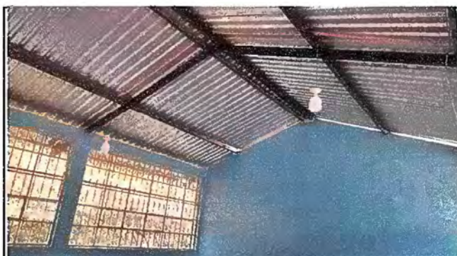
Foto 4: instalacion de unidad de luz
