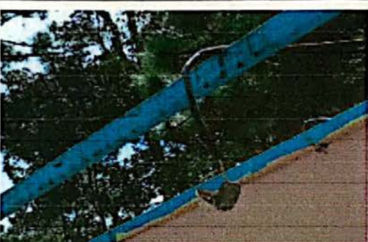
Foto 4: modulo 1 Sustitucion de elemento de fijación (tornillos)
