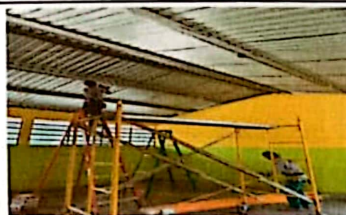
Foto 4: sustrucción de sistema eléctrico
