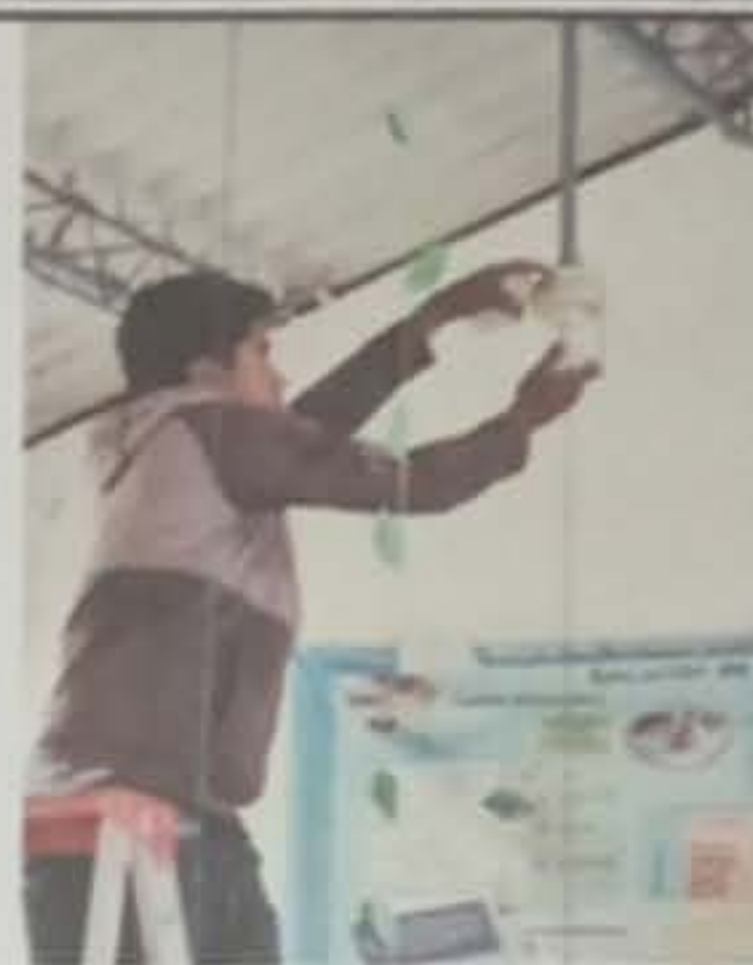
Módulo 1: Sustitución de lamparas tipo LED
