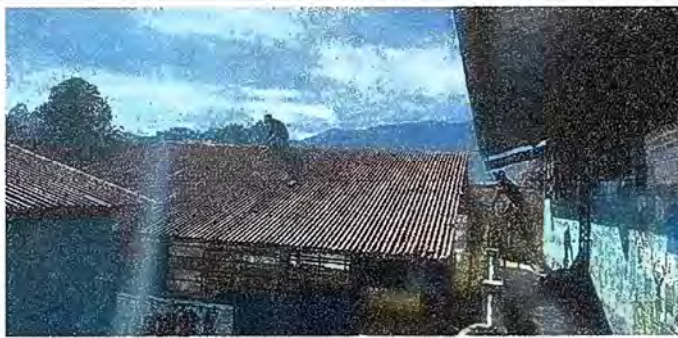
Foto 3. Módulo 1: Sustrucion de capote de lamina para lámina troquelada.
