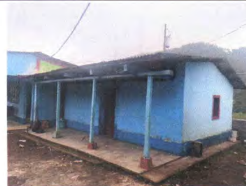
Foto 6: Módulo de aulas que necesita el reemplazo de cubierta de lámina, y remozamiento de estructura portante.
