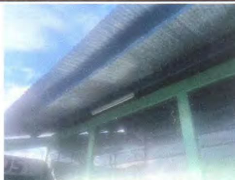
Foto 2: Aula 1 a remozar, requiere cambio de cubierta de lámina y remozamiento de estructura portante.
