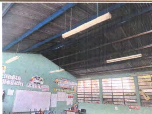
Foto 3: Lámina deteriorada en el interior de aula 1
