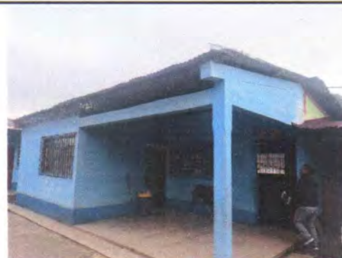
Foto 4: Puede verificarse el deterioro de la cubierta de lámina y falta de instalación de canal de agua.
