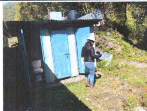
Foto 2: Se requiere remozamiento integral del módulo de baños generales, mejoramiento de muros, cubierta y puertas.
