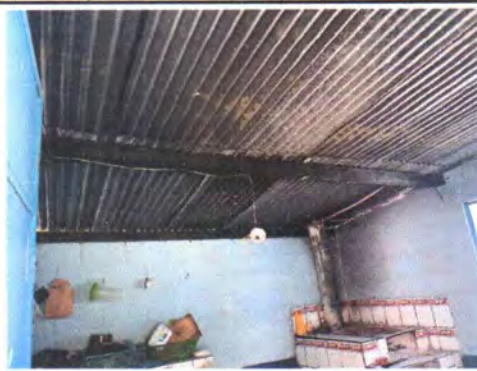
Foto 8: Se requiere mejoramiento de área de cocina, en cubierta y estufa rural.
