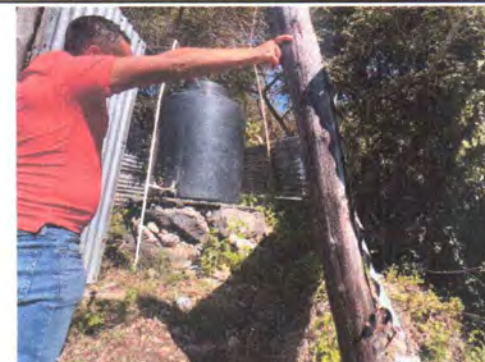
Foto 6: Red de instalación hidráulica en mal estado.
