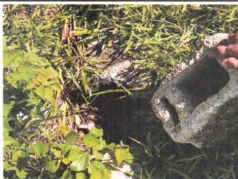
Foto 5: Se requiere mejoramiento de llave de pago de red hidráulica.
