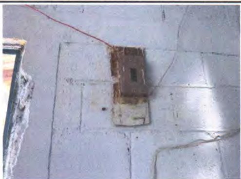
Foto 9: Se requiere remozamiento de red de instalación eléctrica en aulas.
