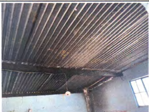
Foto 7: Se requiere mejoramiento de área de cocina, en cubierta de lámina y estructura portante de metal.
