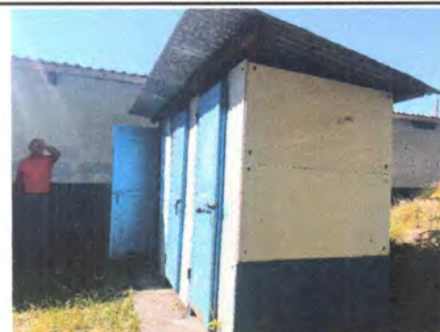
Foto 4: Puede verificarse el deterioro de la cubierta de lámina y puertas
