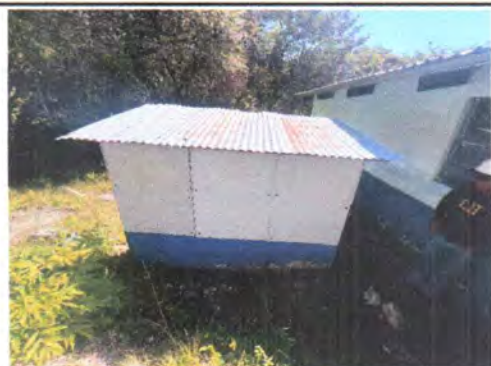
Foto 3: Muros y cubierta deteriorada en módulo de baños generales.
