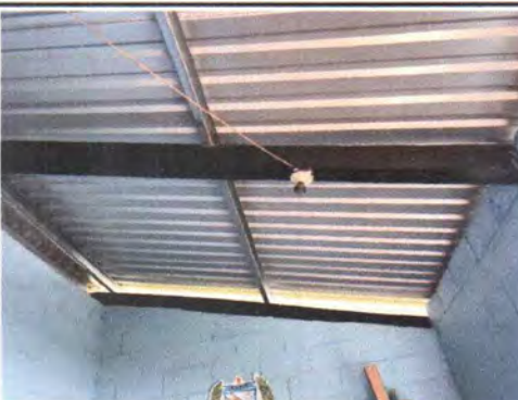
Foto 10: Se requiere remozamiento de red de instalación eléctrica en aulas. Actualmente se encuentra instalada de manera provisional.
