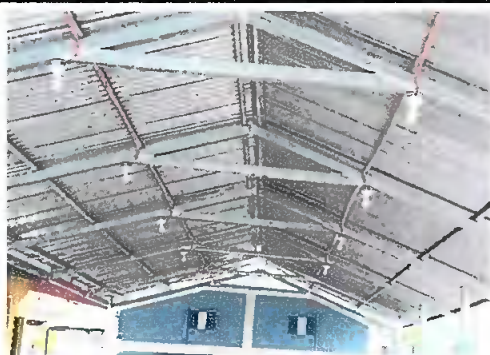
Foto 1: Módulo 4. Focos, se observan focos ahorradores instalados en el patio.
