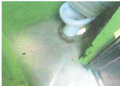
Foto 8: Modulo 3. Piso baño requiere mantenimiento y sustitución.
