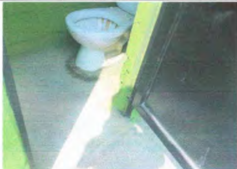
Foto 7: Modulo 3. Piso baño, se observa que tiene fuga y requiere mantenimiento.
