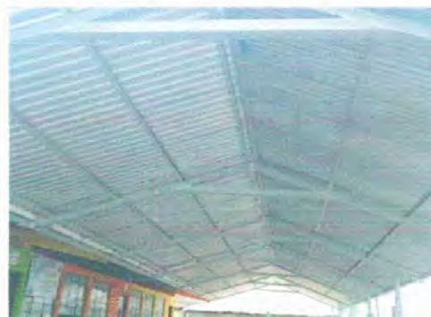
Foto 10: Modulo 4. Se observa carencia de sistema de electricidad en el patio de la escuela, por lo que requiere instalación inmediata.
