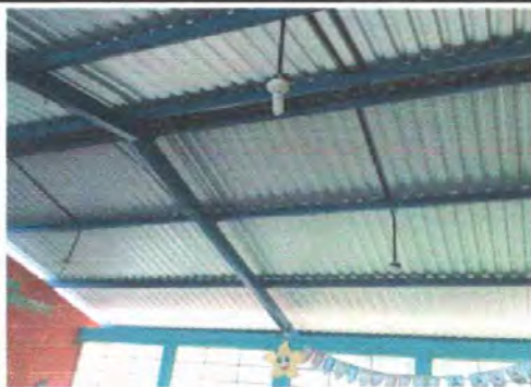
Foto 9: Modulo 4. Sistema eléctrico, se observa falta de foco por fallas en plafoneras, requiere mantenimiento.
