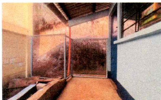
Foto 9: Se puede verificar la instalación de canal pluvial + bajada de agua en módulo de aulas.
