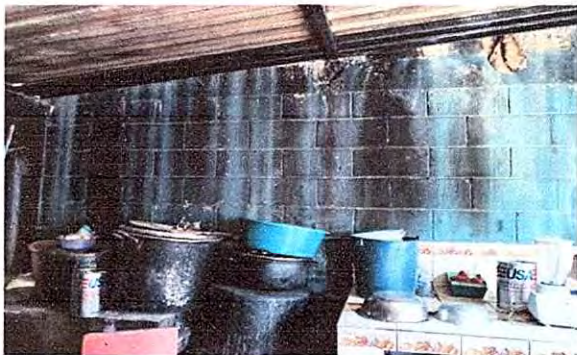
Foto1: Repello de cocina
