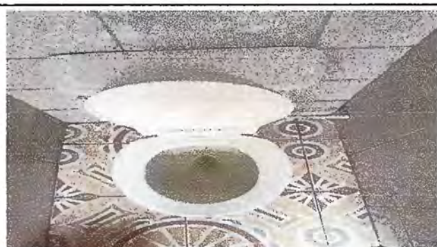
Foto 8: Sustrucción de tapadera sanitario
