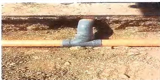
FOTO 17 MODULO 3 TUBERÍA AGUAS PLUVIALES
