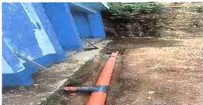
FOTO 15 MODULO 3 TUBERÍA PVC Y ACCESORIOS
