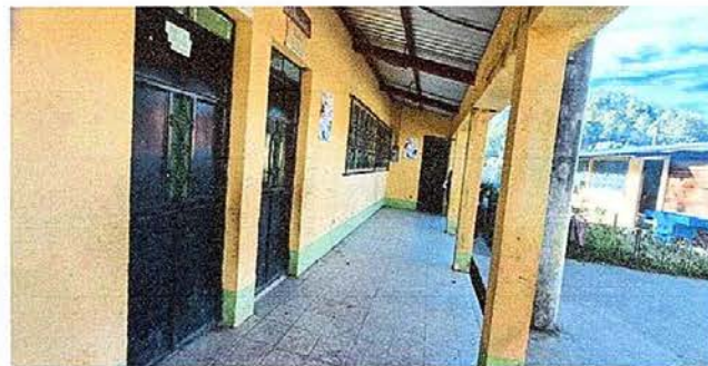
Foto 8: MODULO 2 se muestran las puertas de las aulas a las que se les dara mantenimiento estructural
