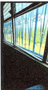
Foto 21 Modulo 3: Mantenimiento a marcos de aluminio
