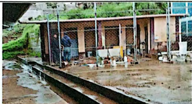
Foto1: Sustrucción de Inodoro
