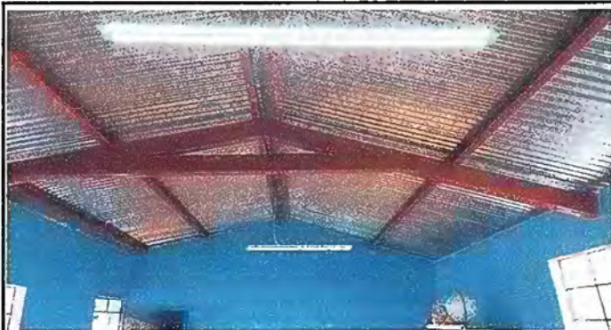
Foto 1: Modulo 1 Situación de lamparas
