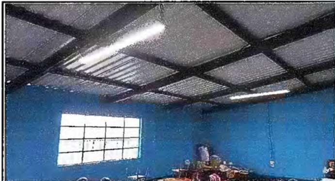
Foto 7: Modulo 3 Situación de lamparas
