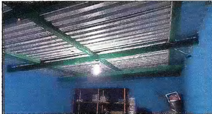
Foto 13: Modulo 5 Situación de lamparas
