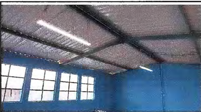
Foto 4: Modulo 2 Situación de lamparas
