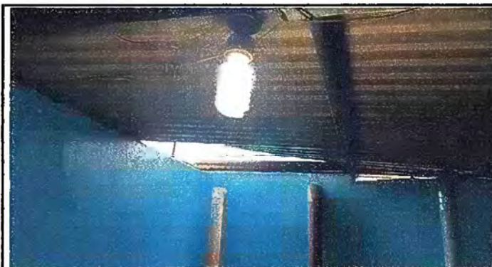
Foto 10: Modulo 4 Situación de lamparas
