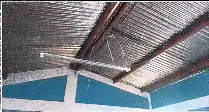
Foto 1: Modulo 1 Situación de lamparas
