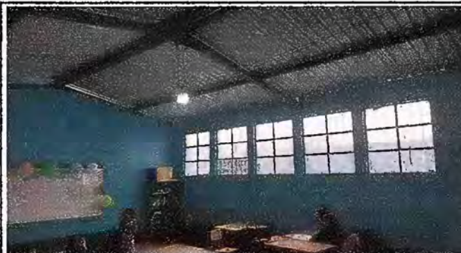
Foto 4: Modulo 2 Situación de lamparas (En proceso)
