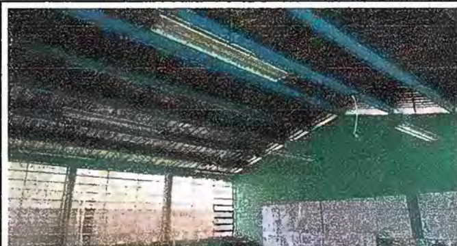
Foto 16: Modulo 6 Situación de lamparas
