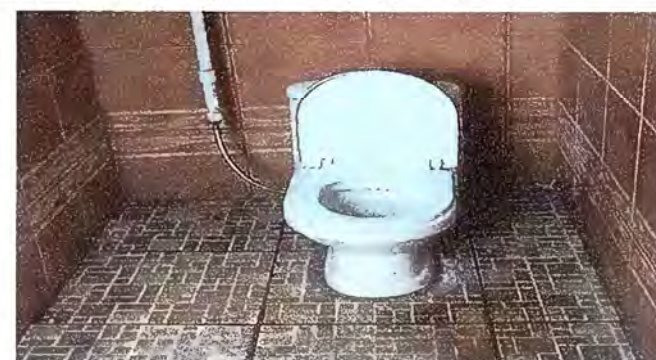
Foto 12: Sustrucción de taza de baño
