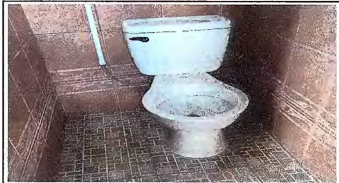
Foto 12: Sustrucción de taza de baño
