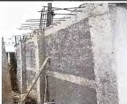
Foto 5: Repello de muro de cocina
