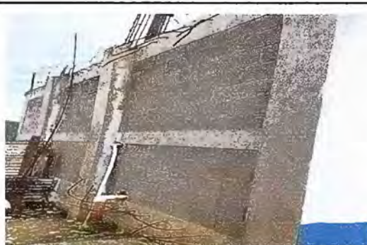
Foto 4: Repello de cocina
