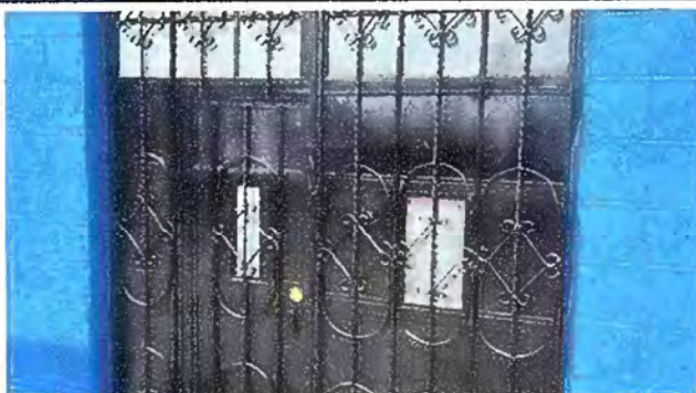
Foto 21: Modulo 6 Sustrucción de Chapa
