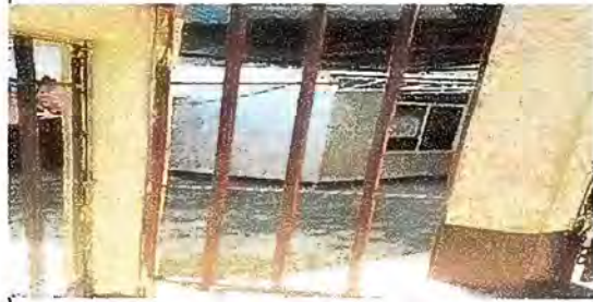
foto 14 Módulo 6 sustitucion de puertas regilla
