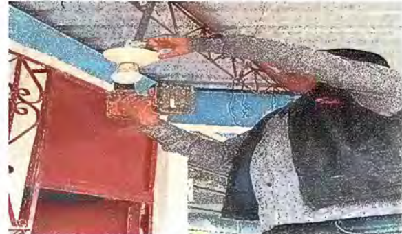
Foto 6: Sistema de energia electrica
