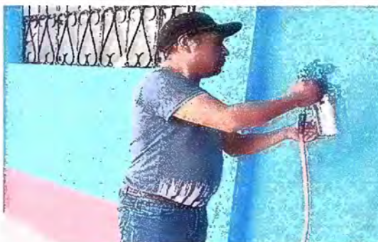
Foto 6: Pintura en general
