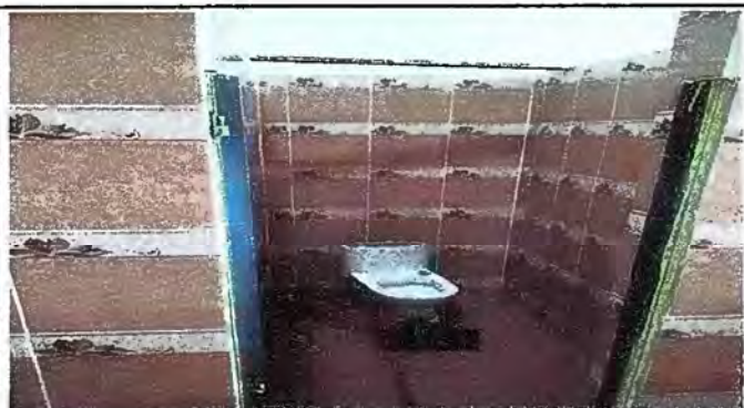
Foto 3 Servicio sanitario: Sustrucción inodoro.
