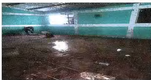
Foto 3: (MODULO 1). En este salón tambien hacen falta de colocación de los zócalos.
